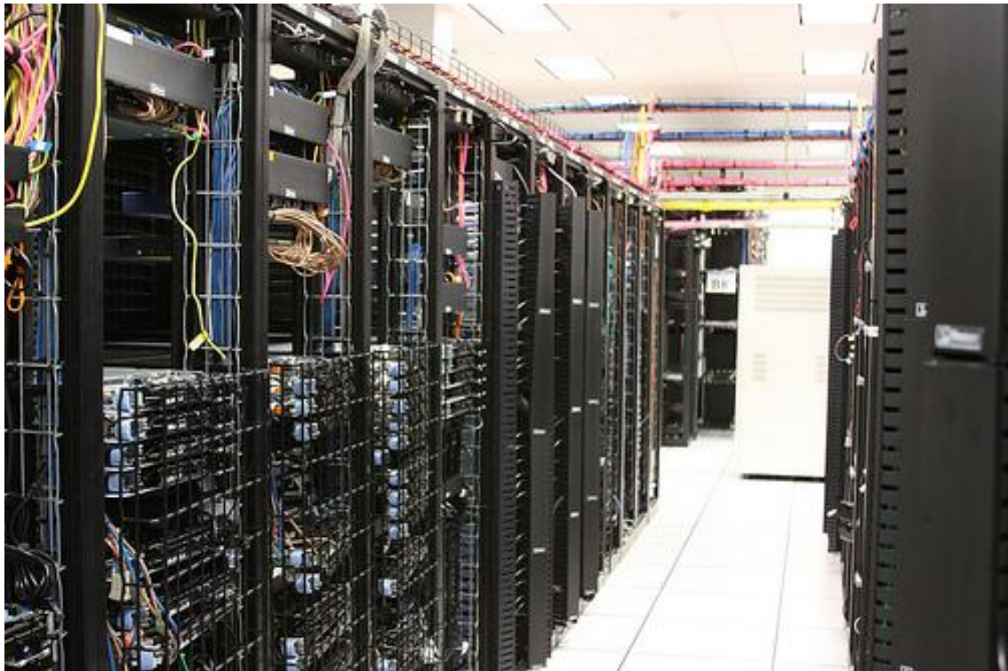
Figura 16: Interior del Datacenter de un proveedor de hosting y servicios web (ThePlanet)
