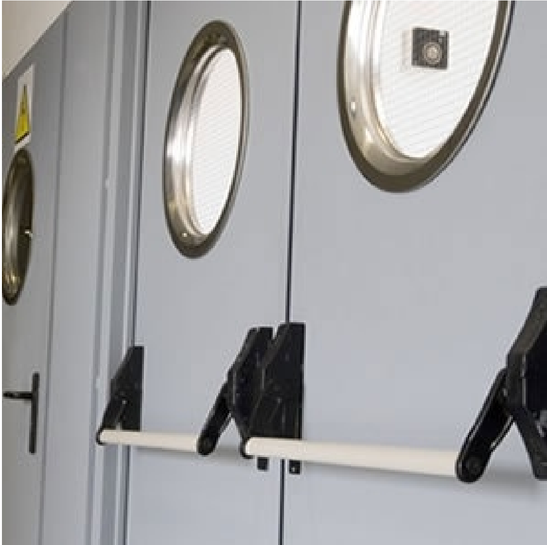
Figura 9: Puertas de seguridad antiincendios
