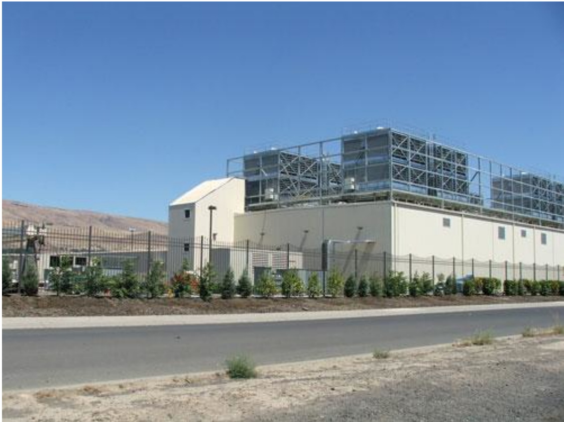
Figura 15: Datacenter de Google en Montain View, California, EEUU. 45000 servidores
